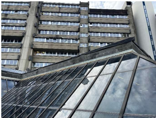
Figure 2 - Vue de la bordure de toit surélevée et du nez de gouttière raccourci, qui a été traité avec un protecteur de barres d'armature.
